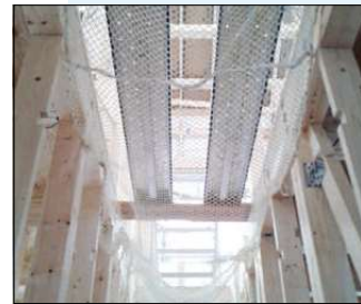
階段室などの床開口落下防止
